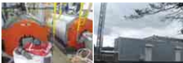
Республика Карелия, Олонецкий р-н, д. Куйтежа, ул. Ленина, д. 136 (установленная мощность объекта — 1 МВт). Использованы водогрейные котлы Duotherm 500 компании Wolf (стр. 171)
