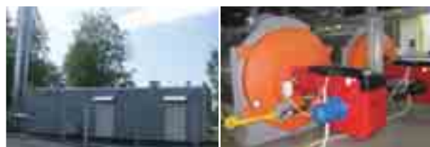
Республика Карелия, Олонецкий р-н, д. Мегрега, ул. Лесная, д. 4 (установленная мощность объекта — 2,2 МВт). Использованы водогрейные котлы Duotherm 1100 компании Wolf (стр. 171)
