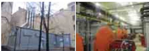
г. Санкт-Петербург, Загородный пр., д. 8 (установленная мощность объекта — 11,2 МВт). Используются водогрейные котлы GKS Dynatherm компании Wolf (стр. 171)
