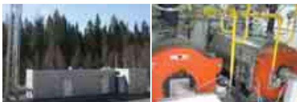
Республика Карелия, г. Лахденпохья, Ленинградское ш., д. 29 (установленная мощность объекта — 1 МВт). Использованы водогрейные котлы Duotherm 500 компании Wolf (стр. 171)
