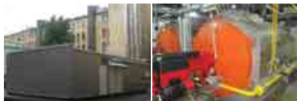
г. Санкт-Петербург, Загородный пр., д. 13 (установленная мощность объекта — 4 МВт). Используются водогрейные котлы GKS Dynatherm компании Wolf (стр. 171)
