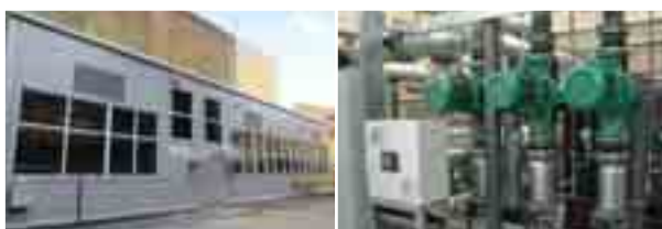
г. Санкт-Петербург, ул. Разъезжая, д. 43/1, лит. В (установленная мощность объекта — 6 МВт)
