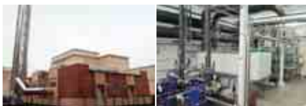
г. Санкт-Петербург, ул. Черняховского, д. 32, корп. 2, лит. А (установленная мощность объекта — 11,68 МВт). Использованы водогрейные котлы GKS Dynatherm 2500 и GKS Dynatherm 4000 компании Wolf (стр. 171)
